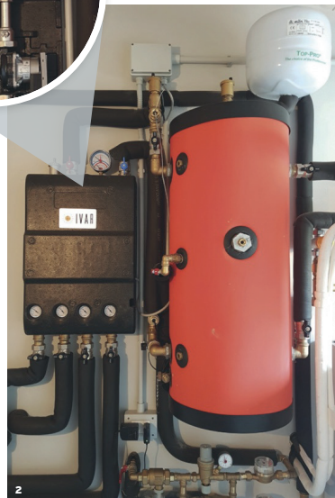
2. CENTRALE TERMICA nell'insieme: in ottica di "compattezza" del locale, si è optato per l'installazione di una pompa di calore avente accumulo per la produzione di ACS integrato. Il risultato è un ambiente di servizio che contiene tutti i sistemi necessari a fornire il giusto comfort termico all'utente.
