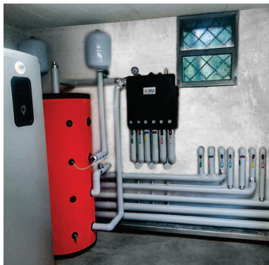
IL PAVIMENTO radiante installato internamente al roccolo
