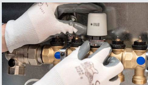
8. LE TESTE ELETTROTHERMICHE consentono il comando on/off della zona a cui il circuito fa riferimento. Qui è stata montata una standard (2 fili) sul collettore di ritorno. A seguito del collegamento delle tubazioni sulle derivazioni, seguiranno il carico dei circuiti, lo sfiato, la prova di pressione e infine il bilanciamento
